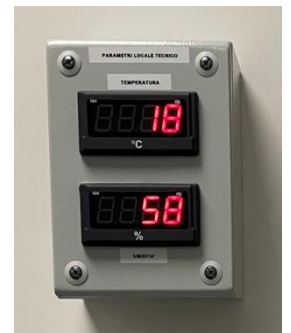
Figura 7: pannello di segnalazione T e UR% nel locale tecnico
