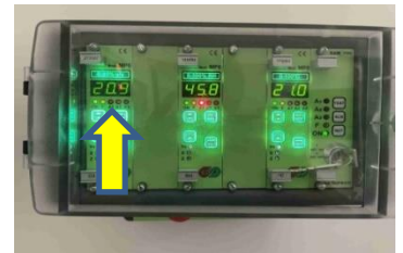
Figura 5: centralina di controllo ossigeno in sala RM
