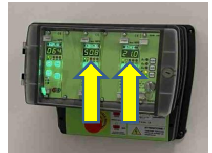
Figura 6: centralina di controllo T e UR% della sala magnete
