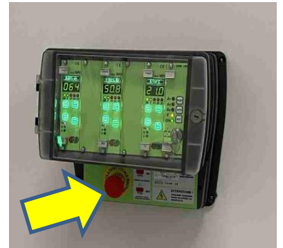
Figura 4: pulsante per attivazione della ventilazione di emergenza
